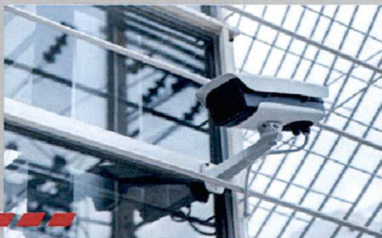
Видеонаблюдение за зданием и территорией
